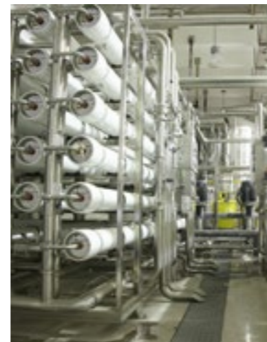
青啤二厂水处理中心
